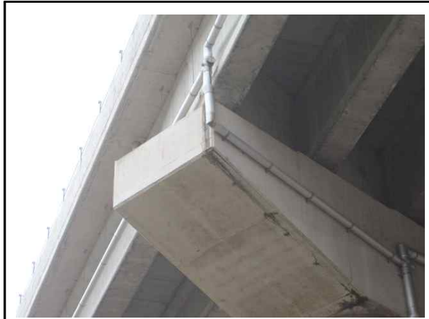
S2 배수시설 배수관 누수
