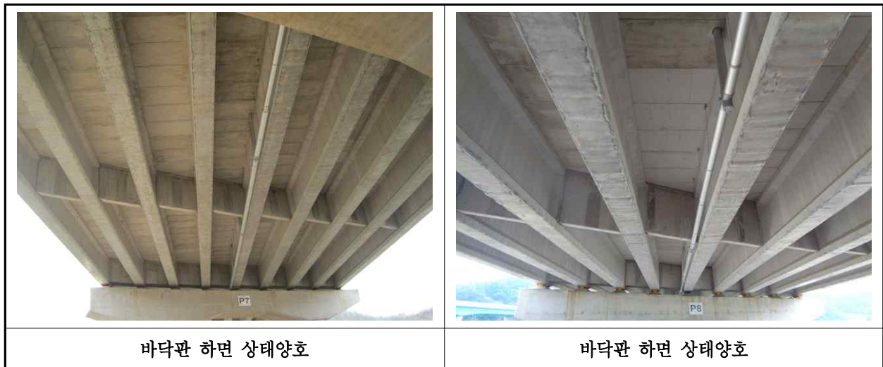
【사진 24.3.3】 바닥판하면 손상현황
