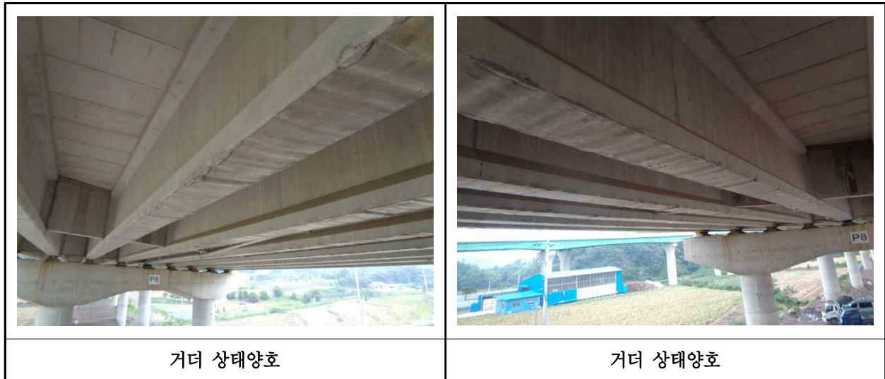
【사진 24.3.5】 거더 손상현황
