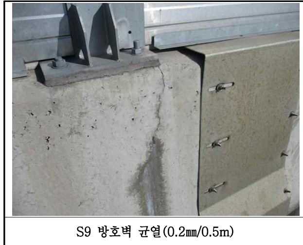
【사진 24.3.24】 방호벽 및 중앙분리대 손상현황
