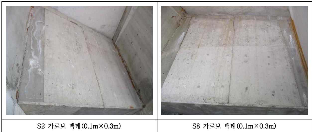
【사진 24.3.7】 가로보 손상현황
